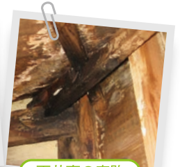
天井裏の腐敗
